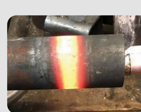
Manutenzione della caldaia a gas : - Induttore Heat Tube S180/D50 - Powerduction 160LG
